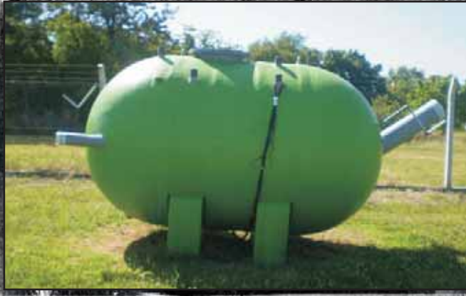
f Foto 12.13. Reactores anaeróbicos para el tratamiento de efluentes líquidos (INTA Castelar – IMyZA)
