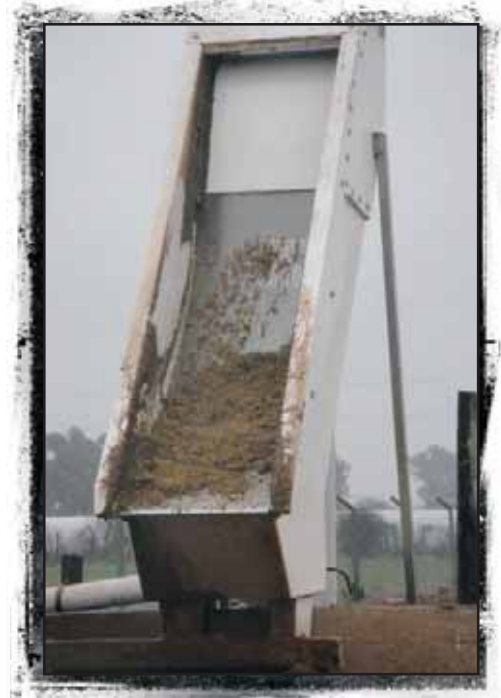
f Foto 12.10. Tamiz ubicado previo al ingreso de la laguna de estabilización en la EEA Rafaela (INTA).
